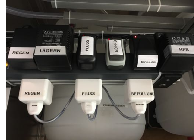
Stecker der 3 Pumpen im Frischwassertank
