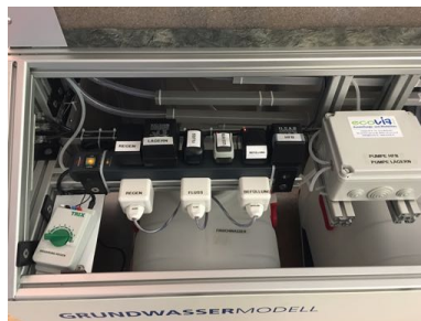
Stromverteilung und Netzteile
